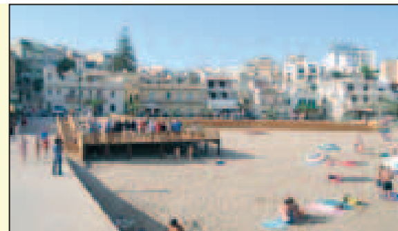
La terrazza realizzata in legno in piazza Empedocle, bella e utile, è destinata a durare pochissimo: numerosi sono già i buchi a poco più di un mese dalla sua inaugurazione.
